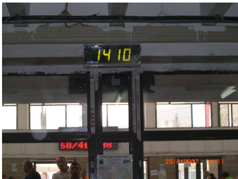
Instalatia de ceasoficare
